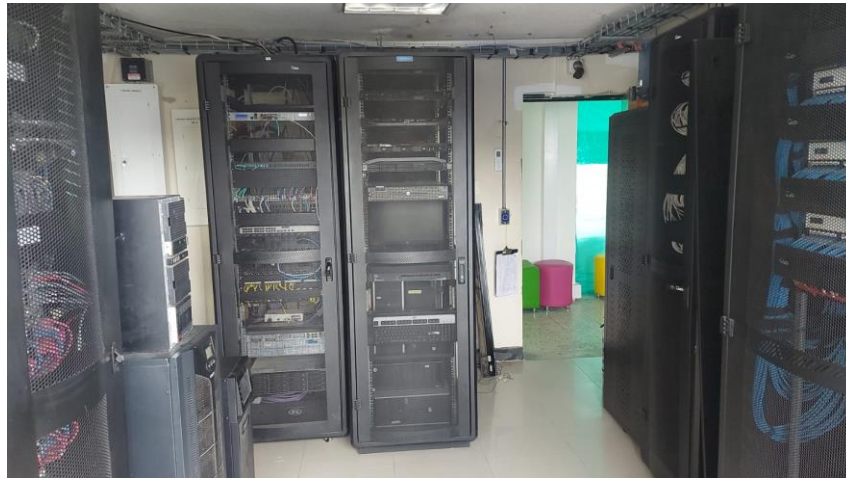
Imagen 18. Data Center administrado por la Oficina de las TIC y Transformación Digital
